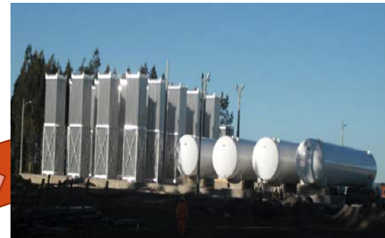
LNG Satellite terminal
